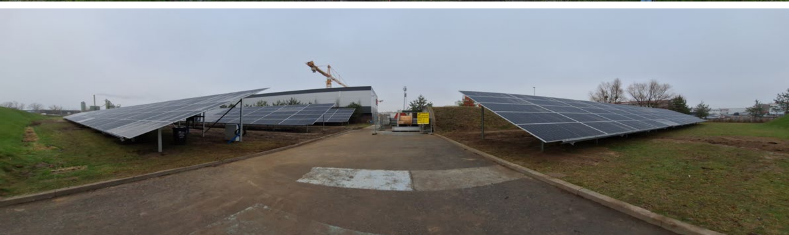
Fot. Panele PV montowane na terenie STRABAG HAUS w Pruszkowie. © STRABAG
